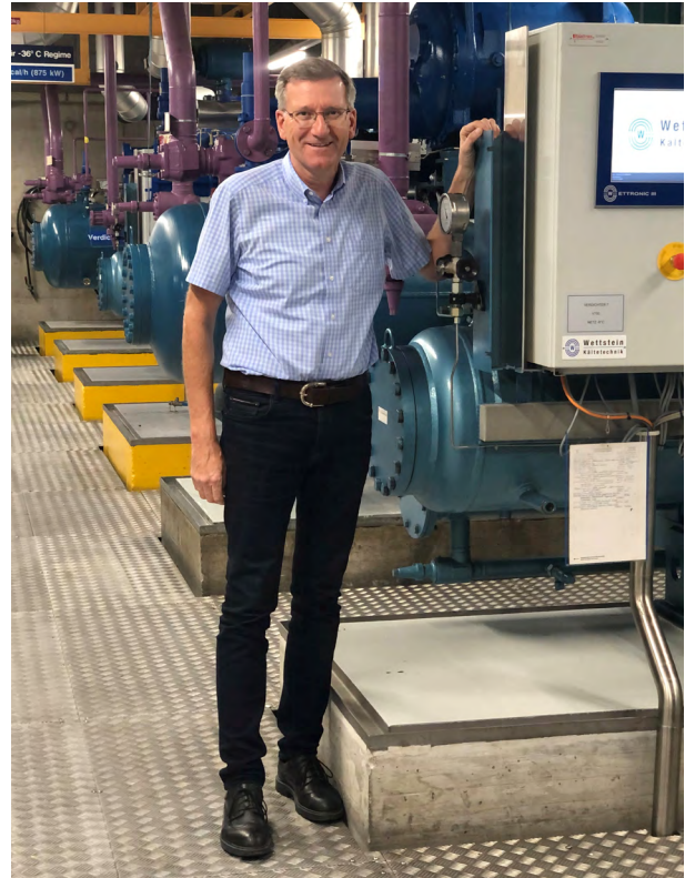
Toni Sigrist in der Kältezentrale einer Nahrungsmittel-Tiefkühlproduktionsanlage.
